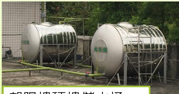
朝陽樓頂樓儲水桶， 提供廁所沖廁
